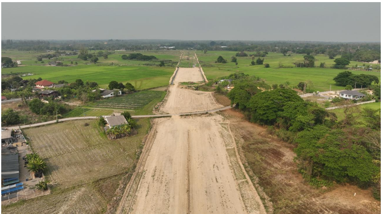
รูปที่ 5-6 ช่วง กม.4+000 (พื้นที่ก่อสร้างถนนสายแยก ทล.11 ถึง ทล.1 อ.เมือง จ.ลำปาง ตอนที่ 1 อยู่ระหว่างดำเนินการก่อสร้าง)
