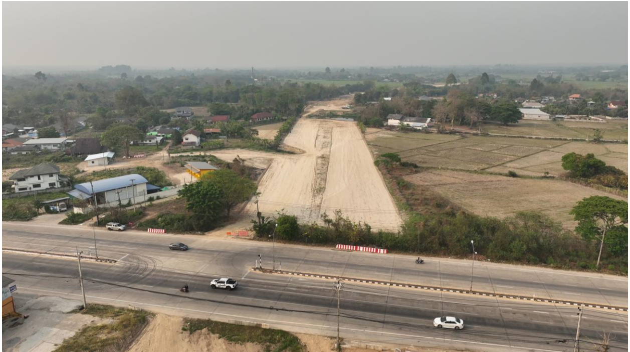
รูปที่ 5-5 ช่วง กม.3+000 ช่วงจุดตัด ทล.1039 (พื้นที่ก่อสร้างถนนสายแยก ทล.11 ถึง ทล.1 อ.เมือง จ.ลำปาง ตอนที่ 1 อยู่ระหว่างดำเนินการก่อสร้าง)
